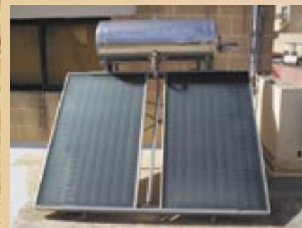
Ritratt ta' Solar Water Heater fuq bejt ta' dar.
